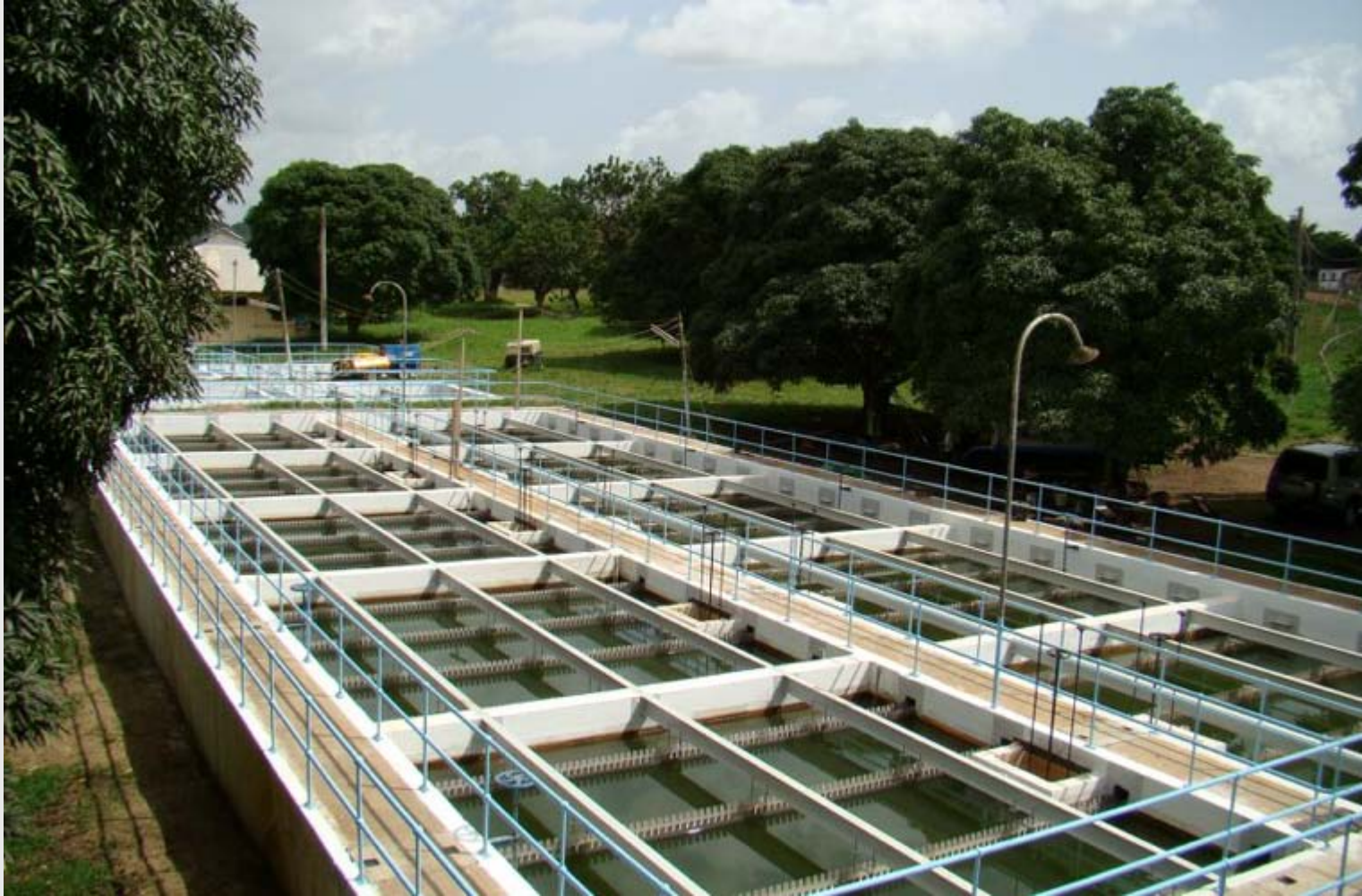
Waterzuiveringsinstallatie, Kumasi Ghana
